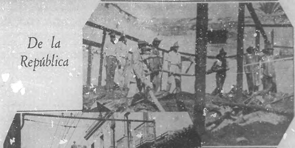
SANTIAGO DE CUBA.—Los obreros trabajando en el incendio del almacén de café de las calles Reina y Cua. Los bombas trabajan sobre el montón de café volado en $150,000 (FOTO MOISES)
